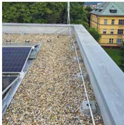
Obr. 1. Vedenie bleskozvodu a zachytávač vyhotovený s vysokonapäťovým vodičom pri kovovej vodičovej atike
