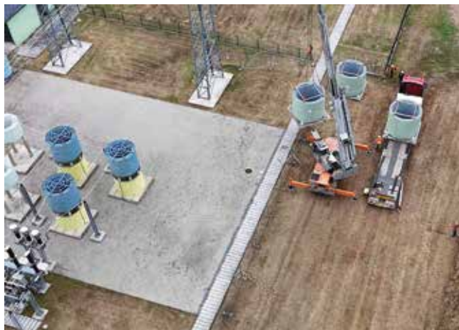
Nové tlmivky dovezené v lete 2025 do elektrickej stanice Stupava
