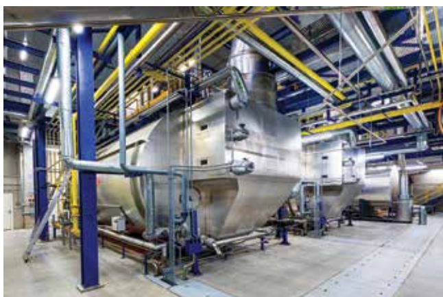
Technológia tepelného zdroja v cukrovare v Opave
